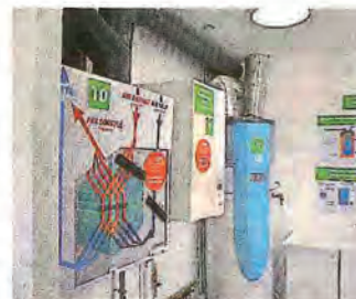
Le visiteur comprend comment fonctionne une pompe à chaleur : sur un tableau, il pourra suivre en temps réel la production d'énergie des 12 m 2 de panneaux photovoltaïques.
