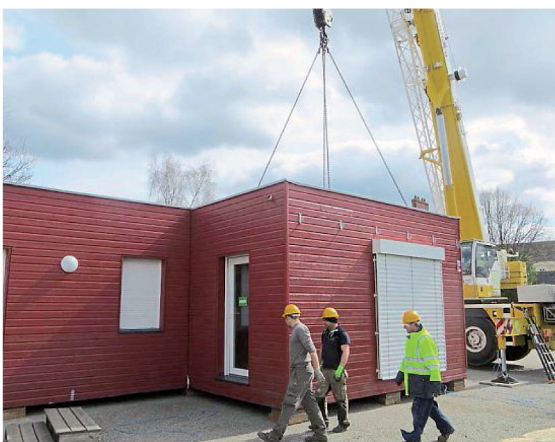
Les modules de la Maison pour agir ont été installés mercredi après-midi, sur le parking de la rue de Notre-Dame-des-Landes. Cette maison itinérante sera ouverte au public à partir du samedi 11 avril.
